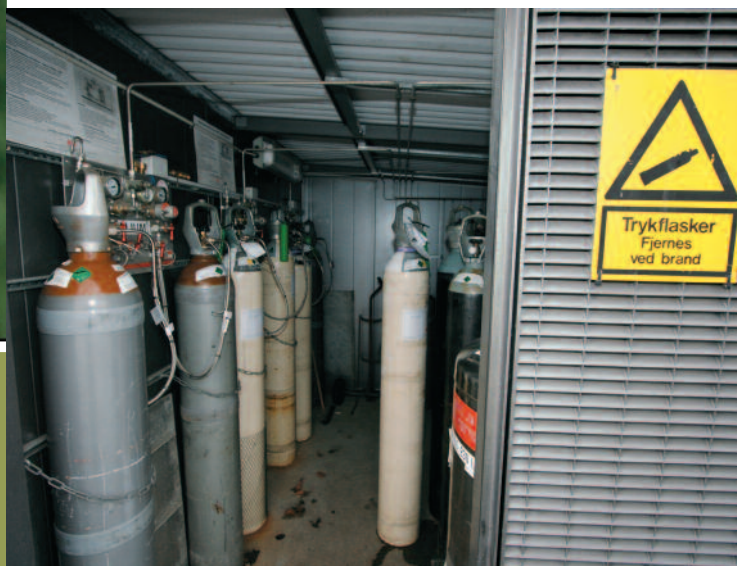
Centralanlæg for gasser med skiltning.
