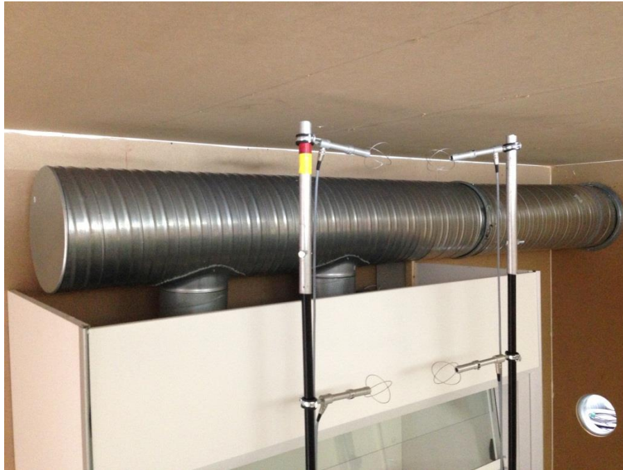
Figur 8 – Udsugningskanalen fra stinkskalet, med to overgange Ø250 til Ø400. I forgrunden kan de to øverste prober på hvert målestativ ses, og nederst til højre er et af overstrømhullerne.
