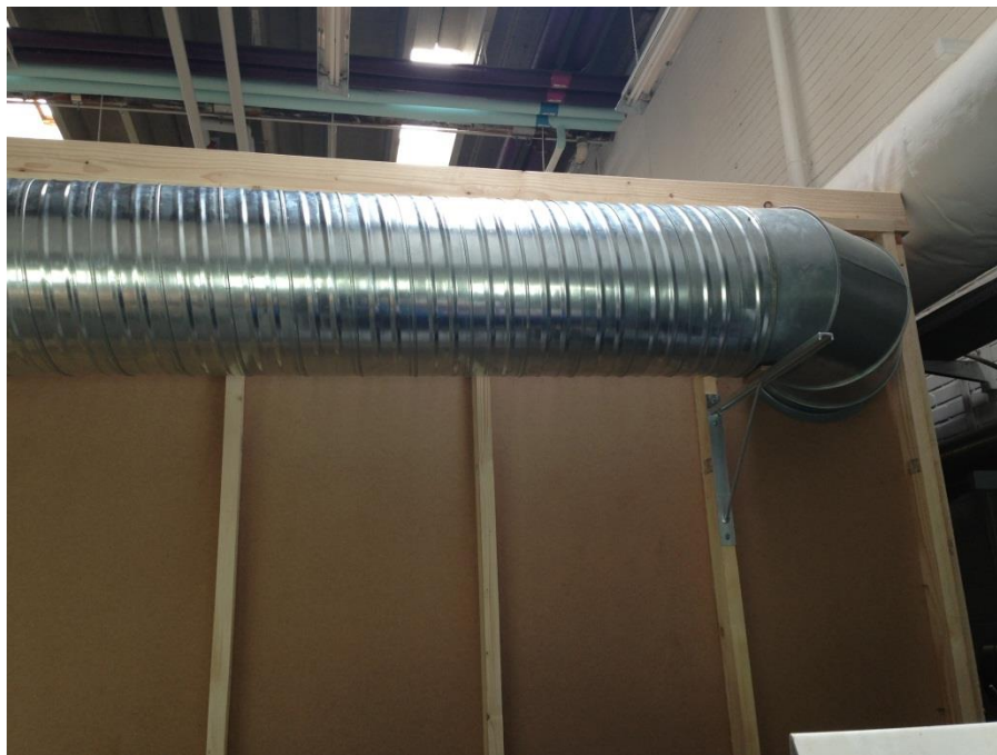
Figur 9 – Bøjning på ydersiden af væggen. Kanalen er holdt oppe af VK6-vægkonsoller.
