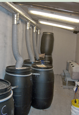
Ventilation i rum til kemikalieaffald
