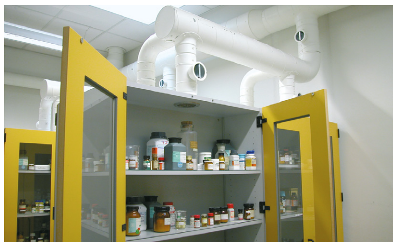
Kemikalier skal normalt opbevares under ventilerede forhold
